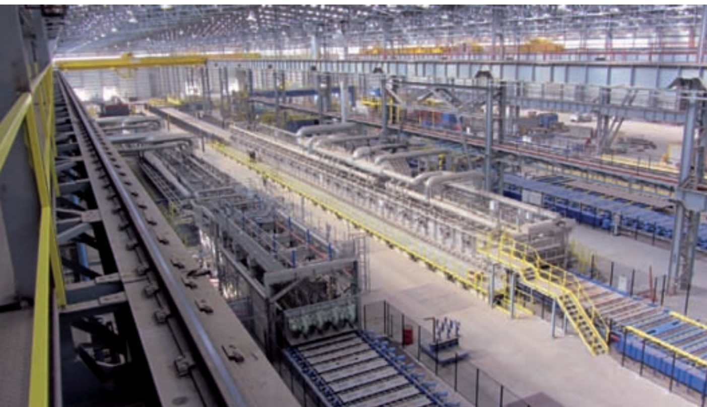
(at this page and at page 34) Quenching and Tempering Plant (Clabecq, Belgium). Civil engineering by Cresco (in questa pagina e a pagina 34) Impianto Quenching and Tempering (Clabecq, Belgio). Ingegneria civile ad opera di Cresco
