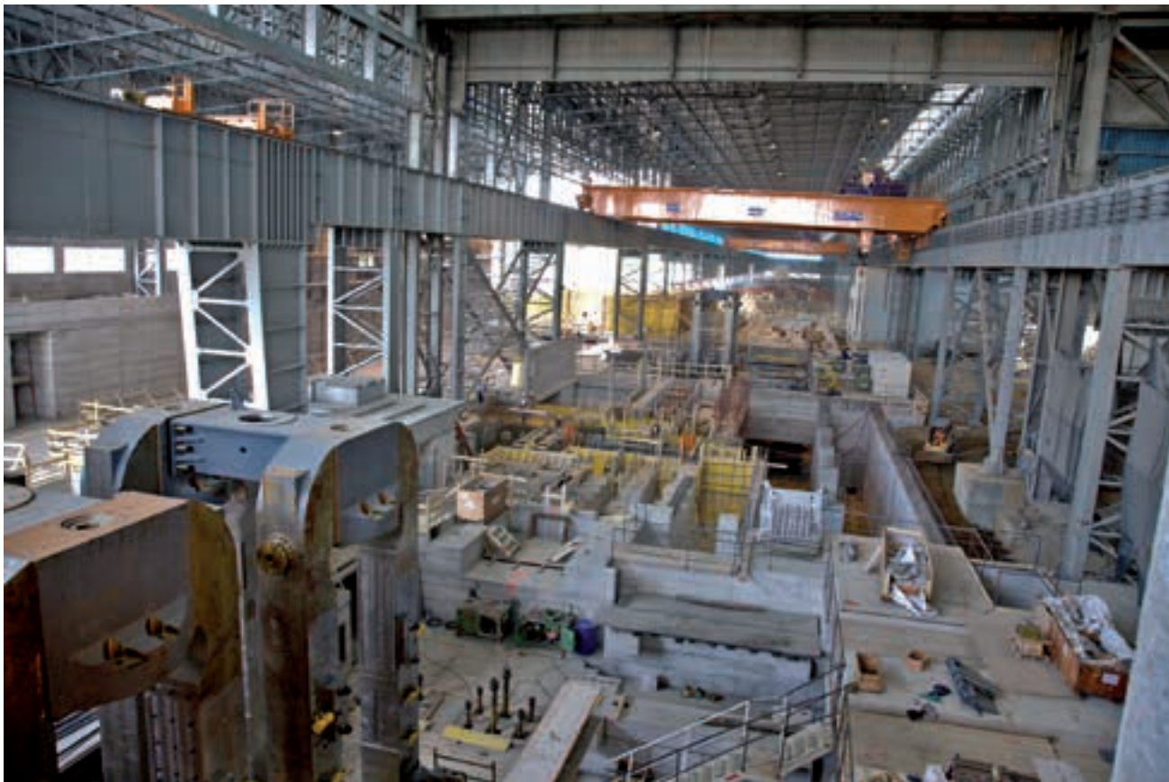
Arvedi continuous casting and rolling mill (Cremona, Italy), building site. Civil works design by Cresco Colata continua e laminatoio Arvedi (Cremona, Italia), cantiere. Progetto delle opere civili a cura di Cresco
